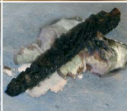
Brannpåvirkning av stenderverk med glassull etter 50 minutter
